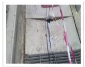
10. 排水路の上にアウトリガーを設置すると割れます
