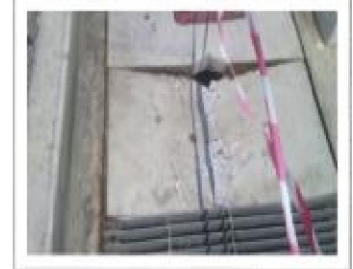
10. ฝาท่อคอนกรีตไม่แข็งแรงพอที่จะรับน้ำหนักรถ
